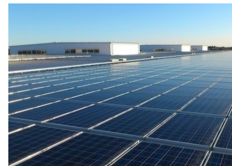
茨城西物流センター 太陽光発電パネル
